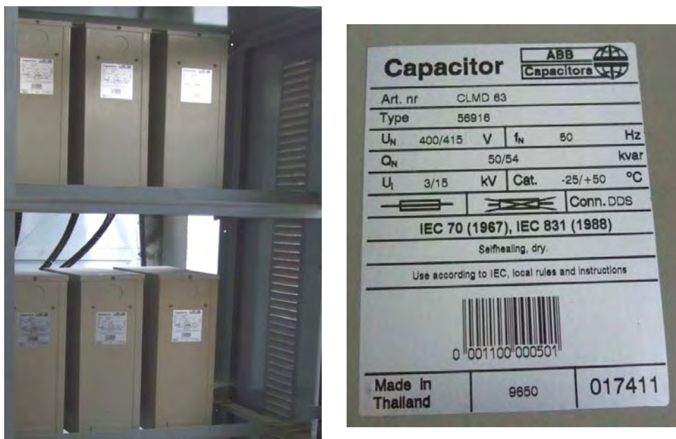
รูปที่ 2.14 Capacitor Bank หรือ Cap Bank
