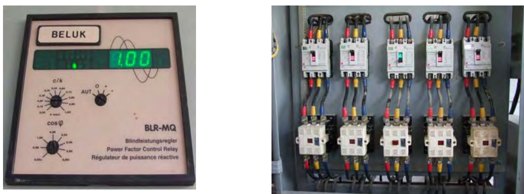
รูปที่ 2.15 Power Factor Controller และอุปกรณ์ตัดต่อ Cap Bank
