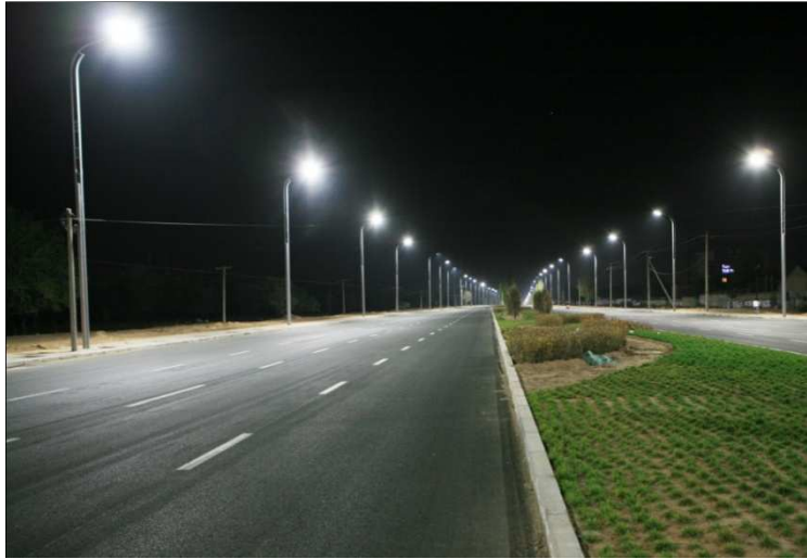
รูปที่ 2.6.4-6 ไฟฟ้าแสงสว่างถนน แบบปรอทความดันไอสูง
