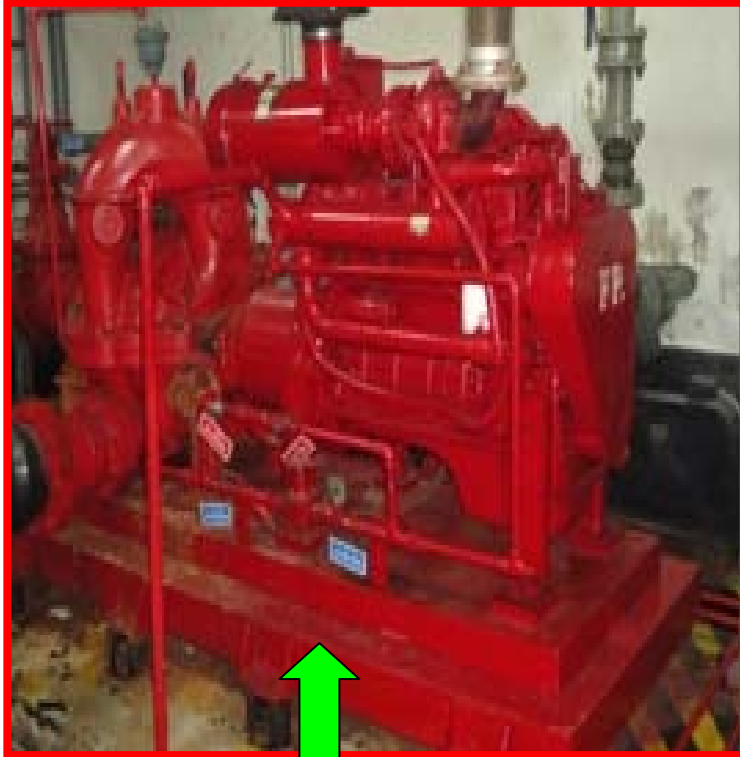
ภาพ FIRE PUMP
